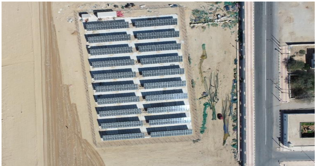
Champs photovoltaïque au Port de Laâyoune sur une superficie de 5000 m 2
